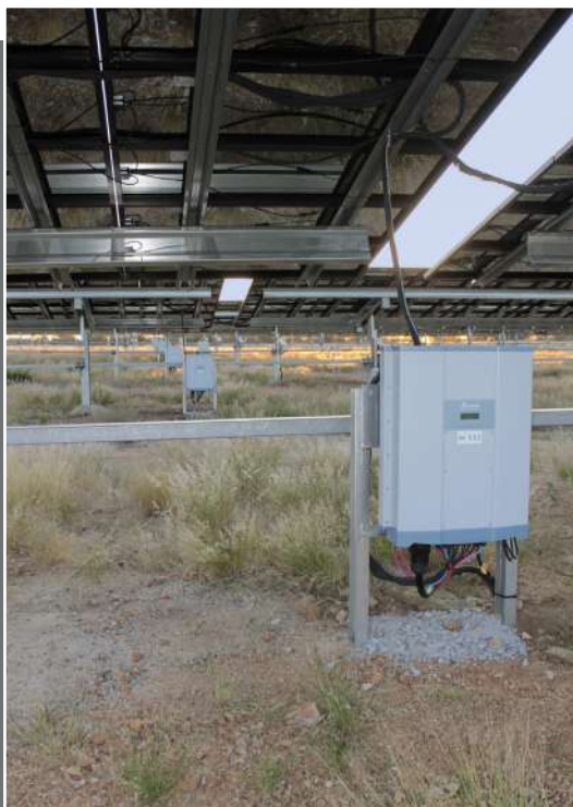
La parte frontale dell'inverter, sotto i pannelli solari
