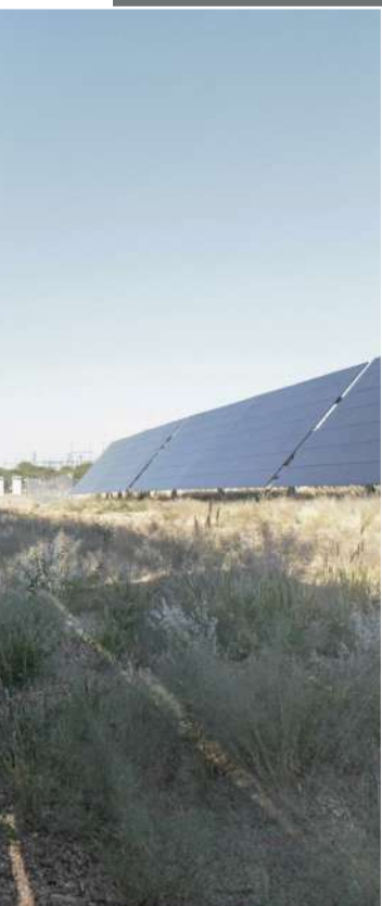
L'inverter M50A e il sistema di inseguimento solare
